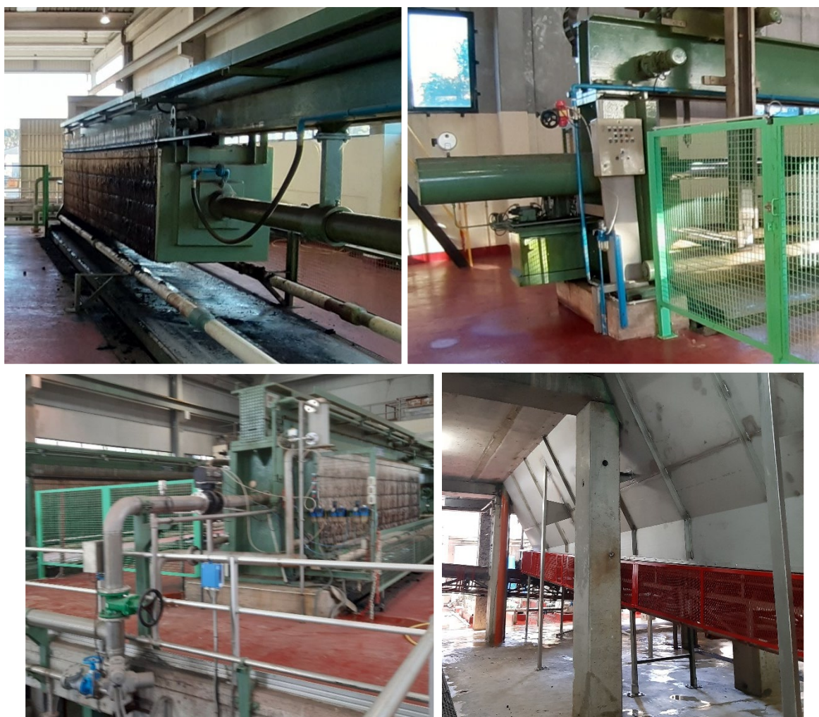
Fig. 2. Imatges dels filtres pressa i de la tolva a sota que recull el fang.
