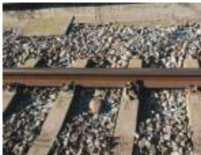
Foto n°3. Fragment de roca entre rails (any 2015).
