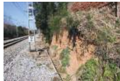
Foto nº1. Material erosionat acumulat a la cuneta.
