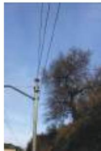
Foto n°2. Arbre en capçalera a prop de fer contacte amb el cable feeder, al pk 23+980
