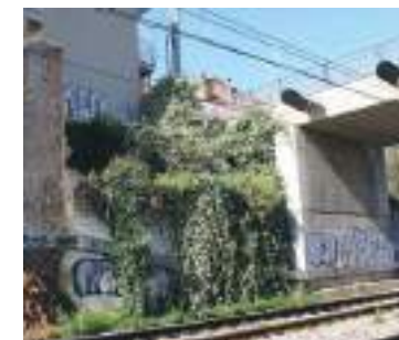
Foto n°2. Mur de formigó i riosta tapats per la vegetació
