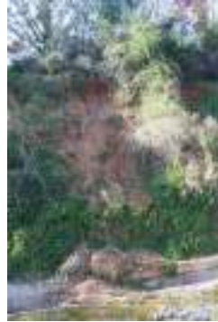
Foto nº2. Esllavissada al PK 12+500.
