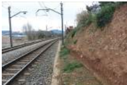
Foto n°2. Lleuger descalçament del tram inicial del talús.
