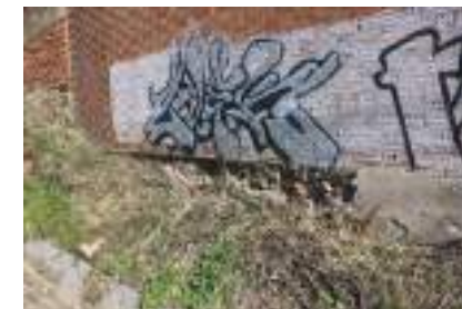
Foto nº2. Petit descalçament del mur de tancament
