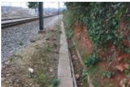
Foto n°1. Acumulació de material a la cuneta.
