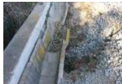
Foto nº1. Erosió al PK 13+500
