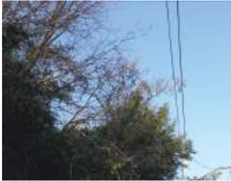
Foto nº1. Branques d'arbres a prop de fer contacte amb el cable feeder.
