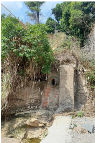
Zona afectada sense desbrossar
