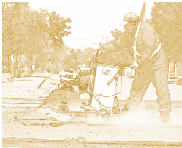
Il·lustració 3 tall en el paviment asfàltic
