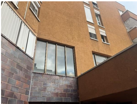
Zona C – fusteria a substituir E20.
