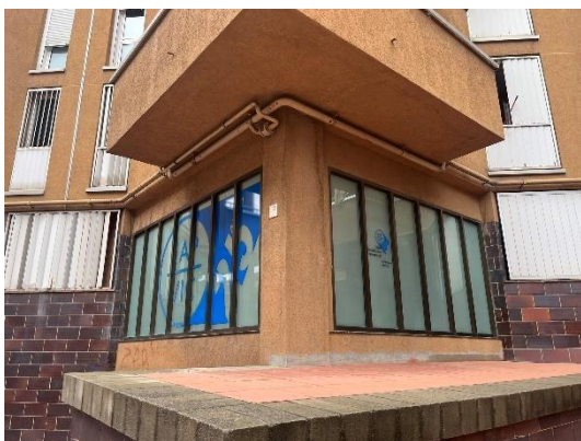
Zona A – fusteria a substituir E26, i E27.
