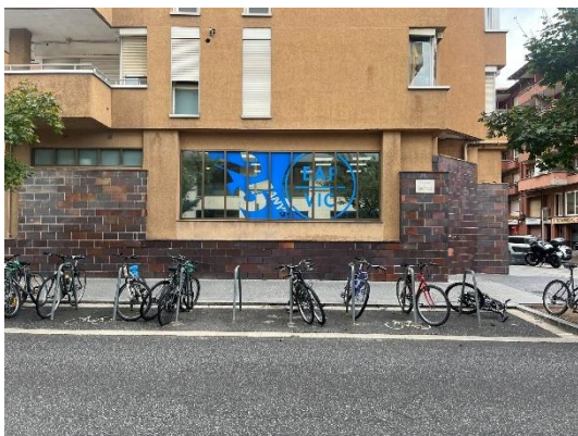
Zona A – fusteria a substituir E30, E29 i E28.
