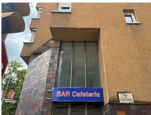
Zona C – fusteria a substituir E09.
