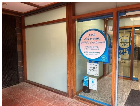
Zona A – fusteria a substituir E33, E34 i
