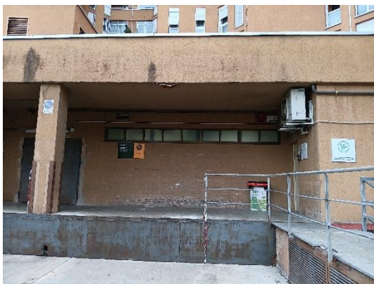
Zona A – fusteria a substituir E32 i E21.
