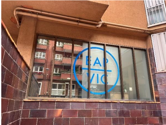
Zona A – fusteria a substituir E21 i E22.
