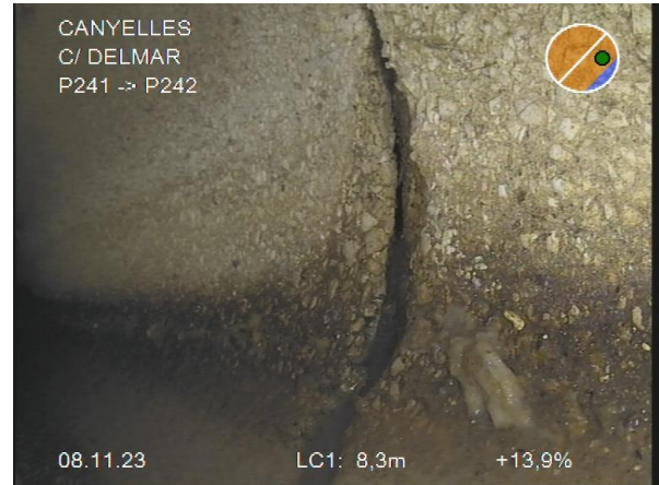
P242-P241_5a8d1a52-8c22-458d-b0c7-a018ae352a08_20231108_101356_214.jpg, 00:03:39, 8.30m Observación general / JUNTA CON FALTA DE ESTANQUIEDAD
