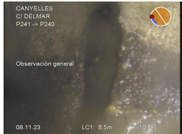
P241-P240_6e9656de-6c72-4737-a5c7-30edbbb334c6_20231108_094733_833.jpg, 00:04:11, 8.50m Observación general / JUNTA CON FALTA DE ESTANQUIEDAD
