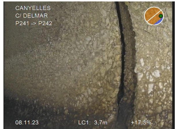
P242-P241_86ef2ee7-88a6-4886-85d8-dc05e7556fa2_20231 108_101131_687.jpg, 00:01:50, 3.70m Observación general / JUNTA CON FALTA DE ESTANQUIEDAD
