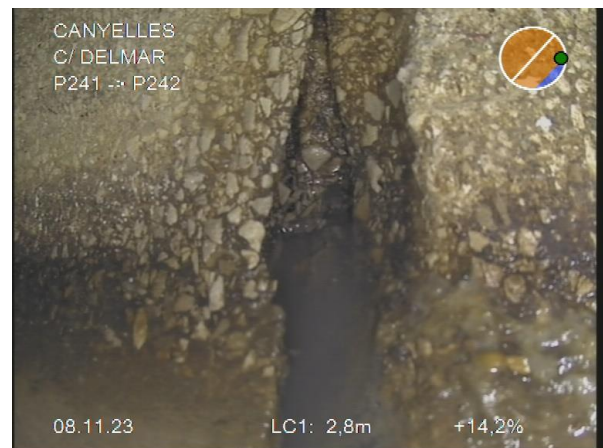
P242-P241_92793e26-0a4c-418d-9431-dd37bab68b6f_2023108_101044_115.jpg, 00:01:14, 2.80m Observación general / JUNTA ROTA
