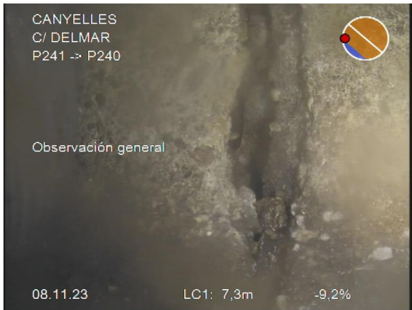
P241-P240_8a3e29f9-b1bc-4ee9-bbad-c53c206ca3b4_20231108_094644_758.jpg, 00:03:31, 7.30m Observación general / JUNTA CON FALTA DE ESTANQUIEDAD
