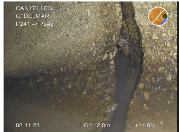
P242-P241_ebf8a929-55b7-4c7a-9493-dc8b60618d69_2023108_100958_450.jpg, 00:00:38, 2.00m Observación general / JUNTA CON FALTA DE ESTANQUIEDAD
