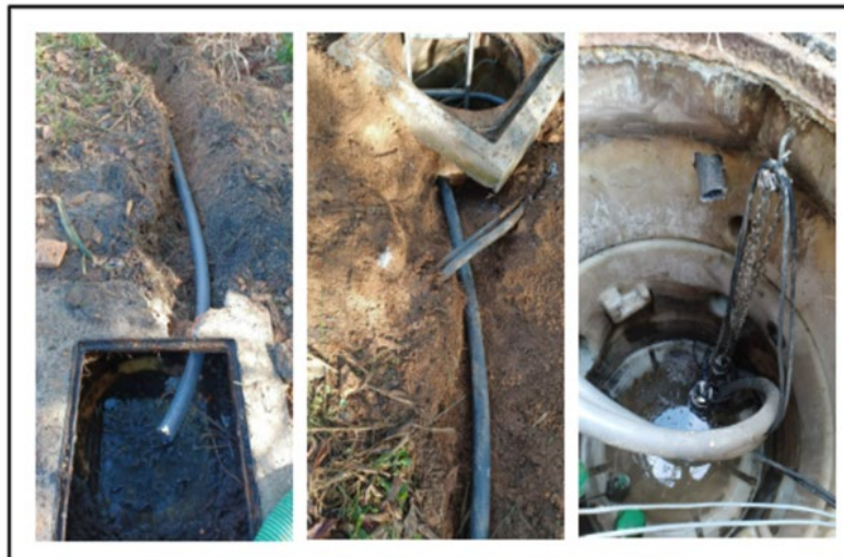
Imatge 6. By-pass provisional 1r dipòsit-pou bombeig
