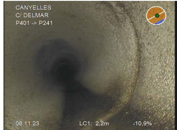
P401-P241_52b94a1f-1010-4166-bb9a-316c1d15f2a9_20231108_091939_144.jpg, 00:00:49, 2.20m Observación general / JUNTA CON FALTA DE ESTANQUIEDAD
