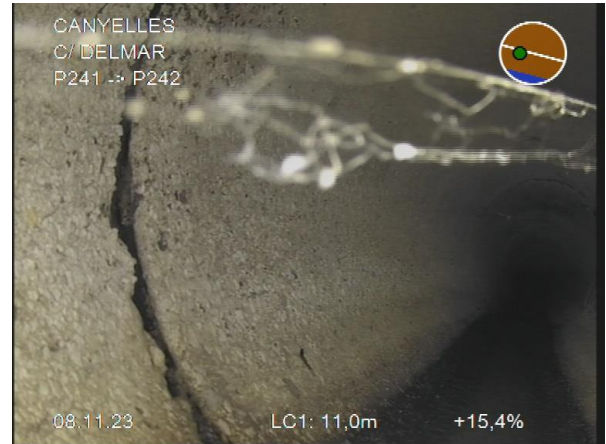
P242-P241_249938b1-1d0a-4362-8d8e-e3a2dcc9480e_20231108_101548_324.jpg, 00:05:12, 11.00m Observación general / JUNTA CON FALTA DE ESTANQUIEDAD
