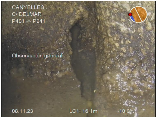
P401-P241_93c3e091-93f3-46e9-9f78-119ff18895dc_20231108_093221_994.jpg, 00:08:45, 16.10m Observación general / JUNTA CON FALTA DE ESTANQUIEDAD
