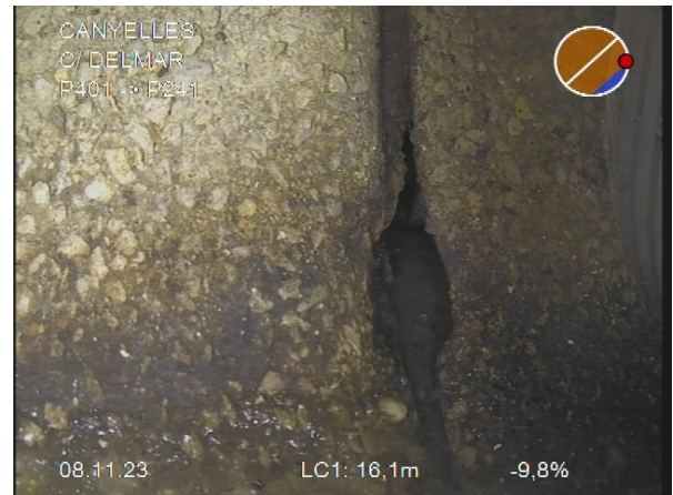
P401-P241_2520474f-d2d0-48e4-a92e-aa07b949801a_20231108_093235_935.jpg, 00:08:45, 16.10m Observación general / JUNTA CON FALTA DE ESTANQUIEDAD
