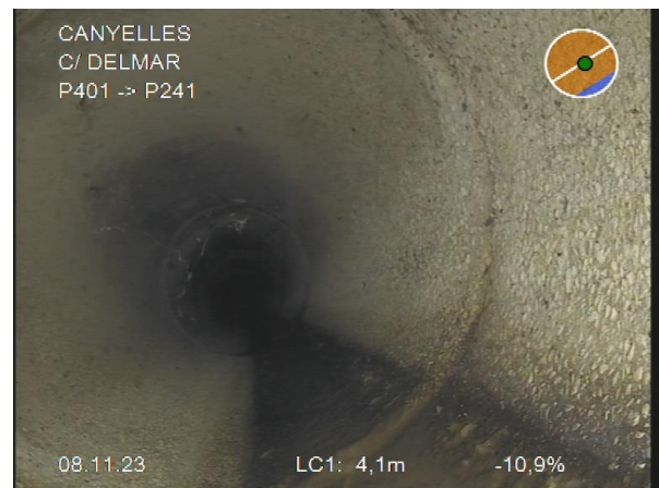
P401-P241_4ca2fa9d-5501-4d7c-93af-c2eb2044a7a7_20231108_092044_370.jpg, 00:01:38, 4.10m Observación general / JUNTA CON FALTA DE ESTANQUIEDAD
