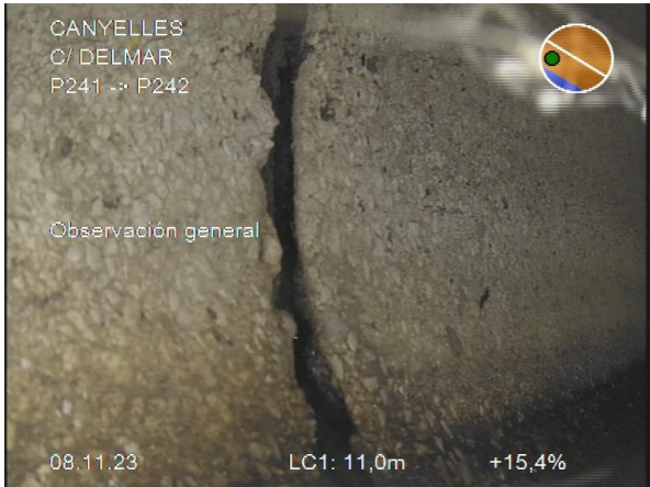
P242-P241_4039b2a9-a94d-4185-b637-f470af7c1eba_20231108_101543_616.jpg, 00:05:12, 11.00m Observación general / JUNTA CON FALTA DE ESTANQUIEDAD
