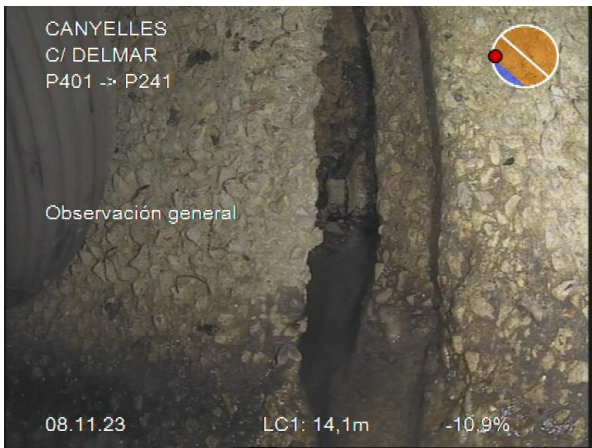
P401-P241_fe4413b9-02a2-4048-96a7-92063e522b05_20231108_093042_228.jpg, 00:07:15, 14.10m Observación general / JUNTA ROTA
