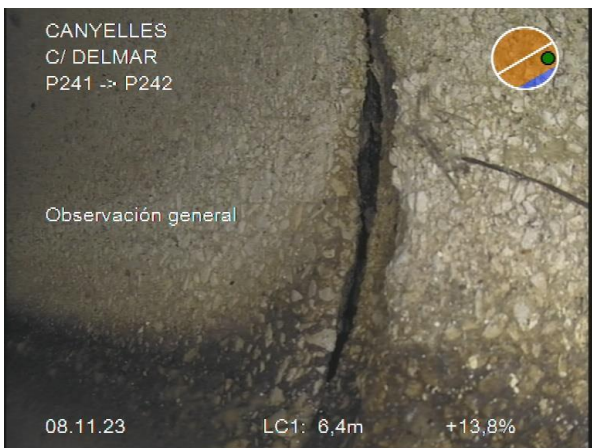
P242-P241_6970e10c-90e9-406c-8c02-61386006f501_20231 108_101229_135.jpg, 00:02:42, 6.40m Observación general / JUNTA CON FALTA DE ESTANQUIEDAD
