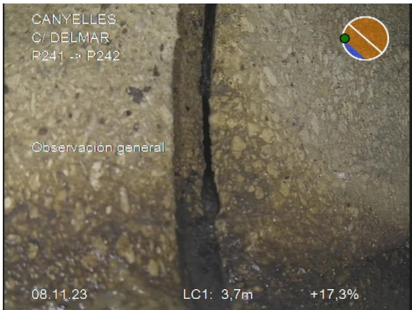
P242-P241_3e97f1e5-9052-40f1-ac02-1c5482b3d976_20231 108_101125_326.jpg, 00:01:50, 3.70m Observación general / JUNTA CON FALTA DE ESTANQUIEDAD
