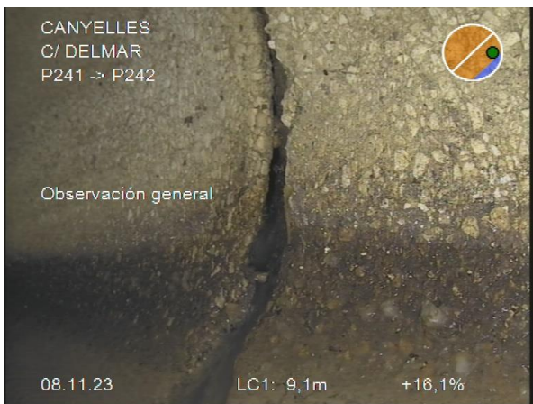
P242-P241_32045aa6-b4ae-4e7b-8dfb-625a3b21c998_20231108_101449_524.jpg, 00:04:32, 9.10m Observación general / JUNTA CON FALTA DE ESTANQUIEDAD
