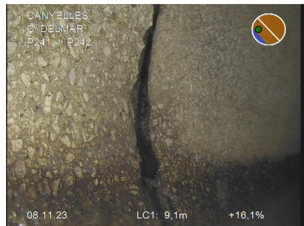
P242-P241_9636a08a-ed9f-4d34-a0e9-b9b4899d299b_20231108_101454_195.jpg, 00:04:32, 9.10m Observación general / JUNTA CON FALTA DE ESTANQUIEDAD
