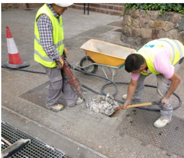
Exemples Canalització Convencional en àmbit municipal.
