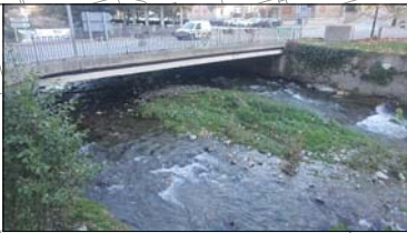
acumulació de sediments sota pont de poca alçada (3 m) 108 m2 / gruix mitjà: 40 cm
