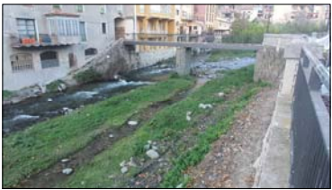
acumulació de sediments que provoca una innecessària erosió de la base edificada oest 356 m2 / gruix mitjà: 40 cm
