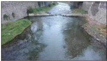
acumulació de sediments que provoca remolí que erosiona el mur de contenció oest retall 16 m2 / gruix mitjà: 60 cm
