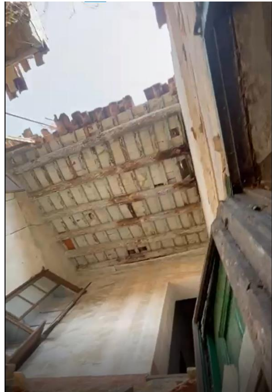
Detall de l'estat de la coberta
