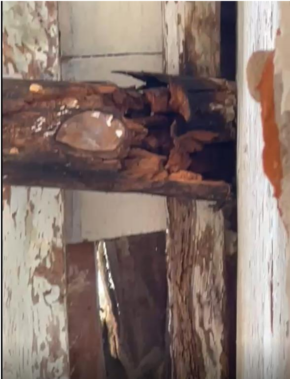
Detall de l'estat de les bigues
