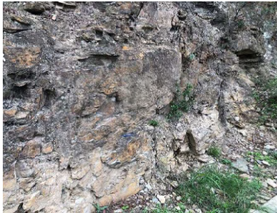
Fotografia 1: Vista dels materials del talús del carrer de Can Cartró. Poc foliat.
