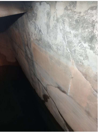
Esquerdes a la part interior del dipòsit.
