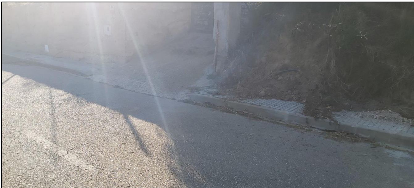
Figura 18. Detall d'escomesa existent sense comptador
