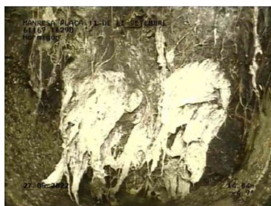
Figura 5. Obstrucció del col·lector per la presència de les arrels.
