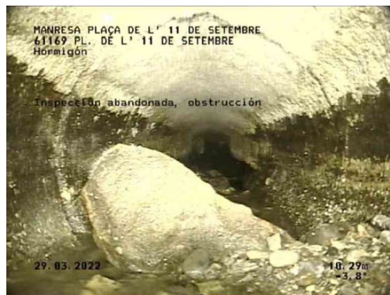
Figura 3. Obstrucció del col·lector.
