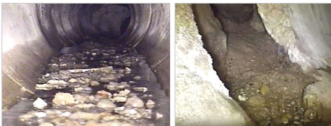
Figura 6. Col·lector P21290-P21299, 2n tram FM-500, sediments (esquerra) i trencament amb fons visible (dreta)
