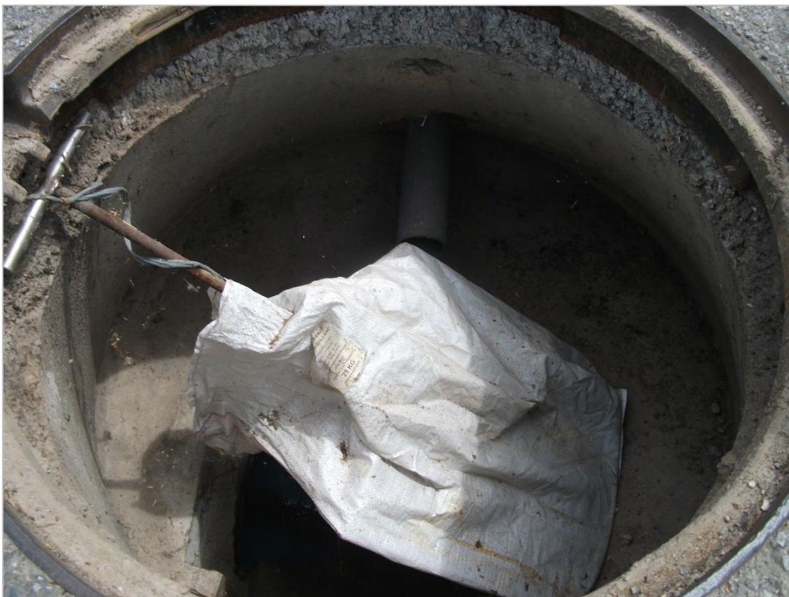
Fotografia 3. Sistema de desviament d'aigua de regadiu al pou de registre P21290.
