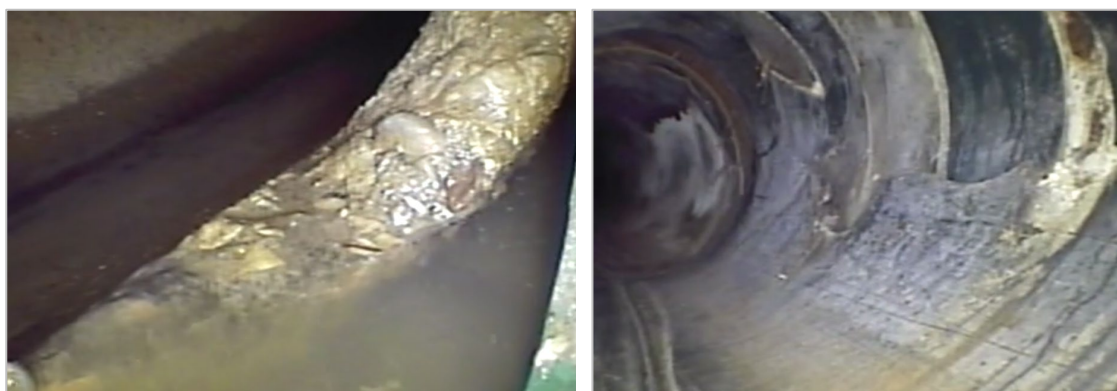
Figura 7. Col·lector P21290-P21299, 3r tram PVC-400, connexió deficient (esquerra) i desprendiments (dreta)
