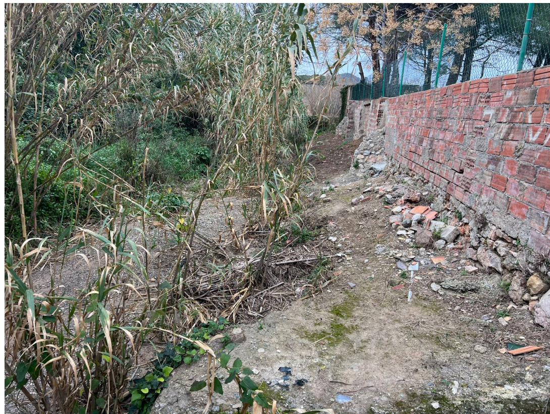
Foto. Els trams de capçalera del barranc del Molí estan ocupats per abocaments de terres i runes, que protegeixen les tanques de propietat. Font: ©Eduardo Soler
