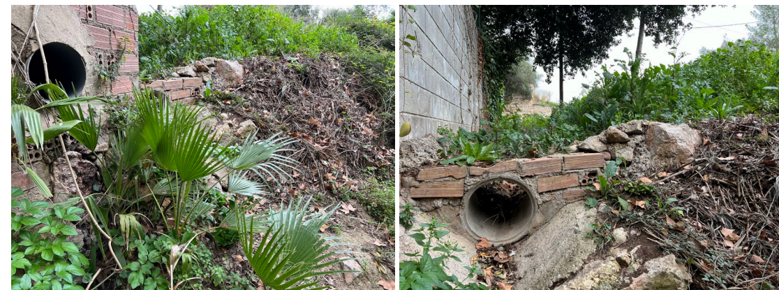
Fotos. La presència de murets, estructures i plantes exòtiques invasores com aquesta washingtonia és una constant en aquest tram de barranc aigües amunt del Passeig de la Boca de la Mina. Font: ©Eduardo Soler
