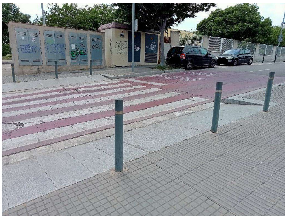
Vorera sud – quadres elèctrics existents
