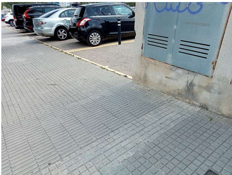
Vorera sud – rasa cablejat quadres elèctrics existents
