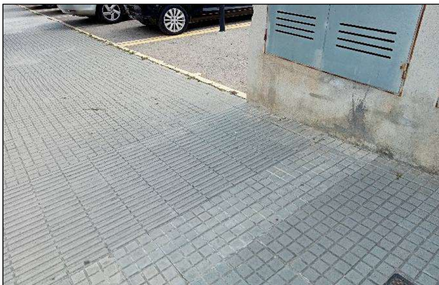
Trobada quadres elèctrics amb vorera
