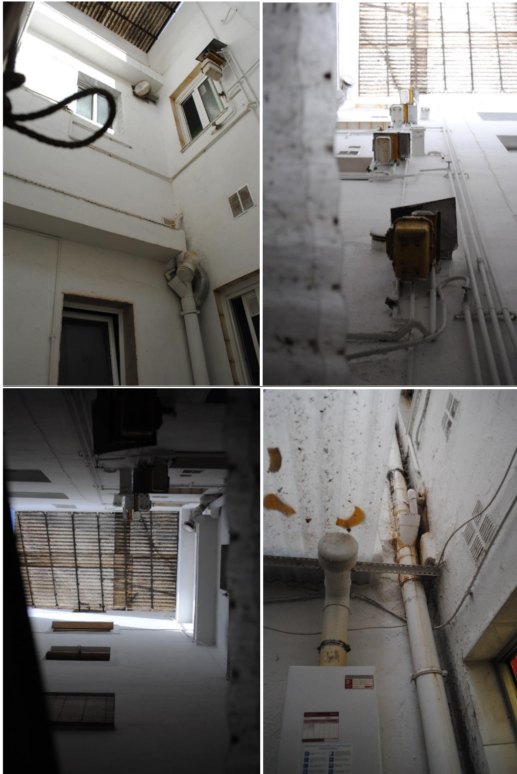
Quatre imatges del pati de llums on es poden veure les instal·lacions existents (subministres particulars i generals d'AS i gas, els corresponents comptadors, baixants de fecals, i ventilacions o extraccions de cuines i banys.
