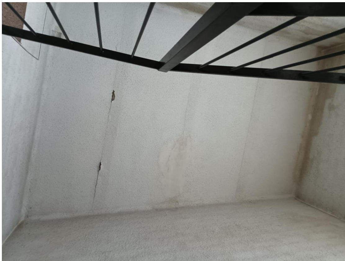
Imatge d'escala de l'edifici i detall de les afeccions de la cara inferior de forjat de coberta d'escala.
