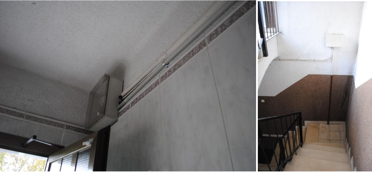
Imatge de l'escomesa a l'entrada de l'edifici i del muntant que discorre per l'escala a partir del que es deriva l'abastiment a cada habitatge.
