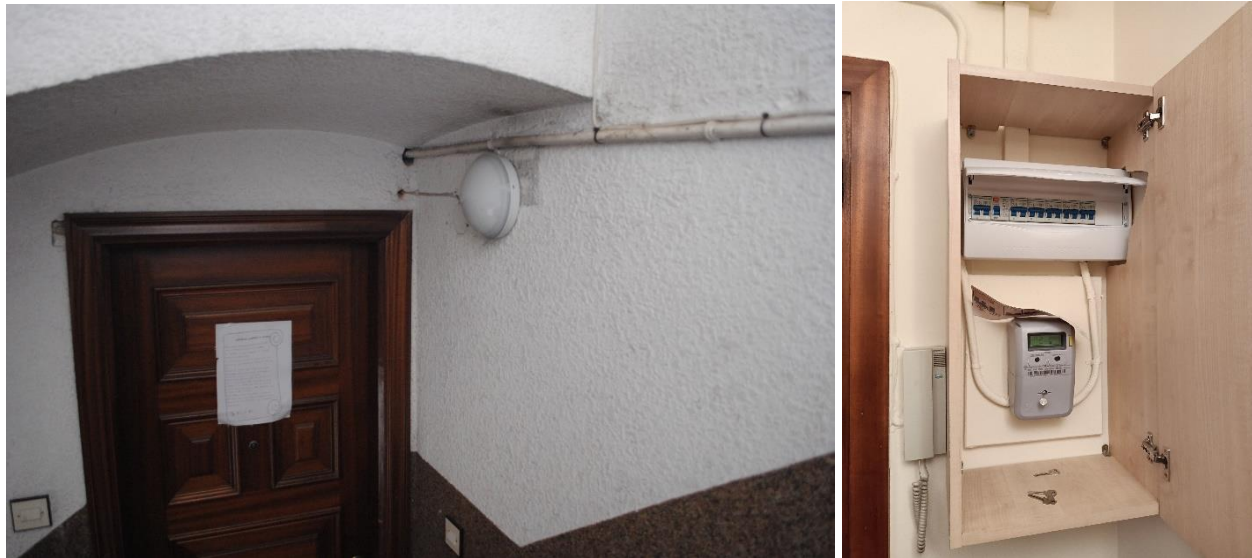
Imatge de l'entrada de la instal·lació a l'habitatge i caixa general de protecció amb comptador.
