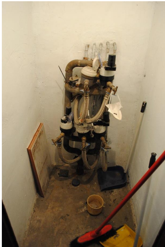
Centralització de comptadors d'AS
