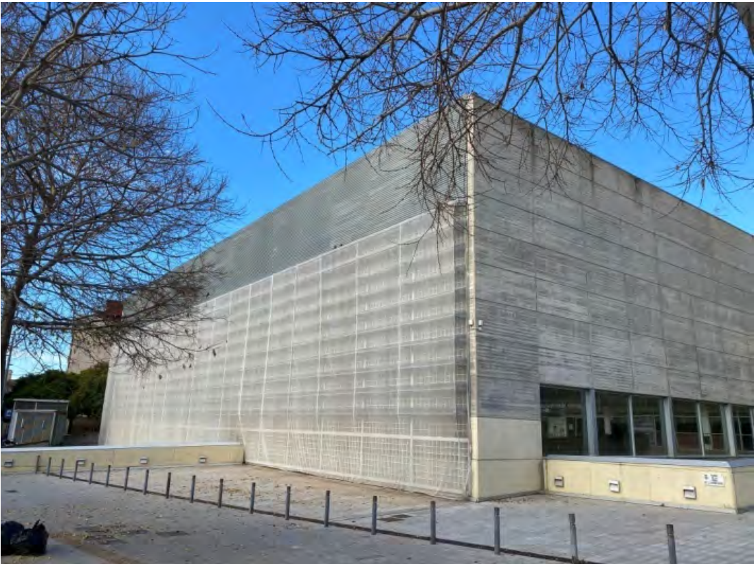
Façana Carrer de la Riera de l'Escorxador, amb xarxa de protecció exterior per evitar desprendiments a la via pública i al pati anglès de l'edifici.
