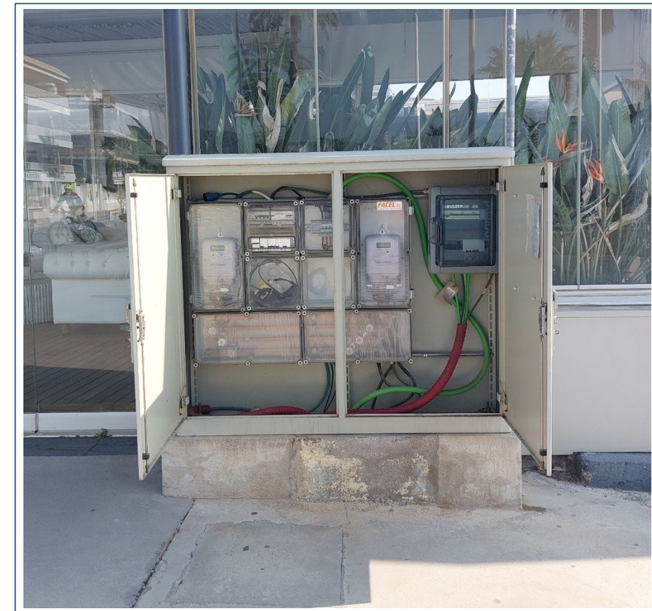
Il·lustració 15: Quadre elèctric existent sense espai
