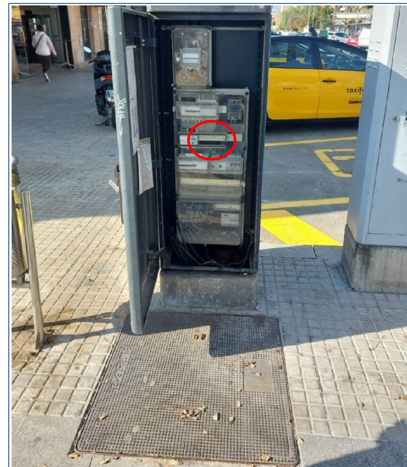
Il·lustració 13: Quadre electric municipal amb espai i arqueta existent davant
