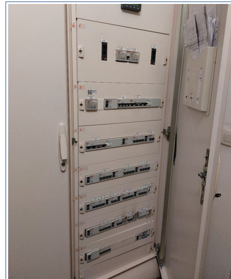
Il·lustració 17: Quadre elèctric del Teatre Plaza
