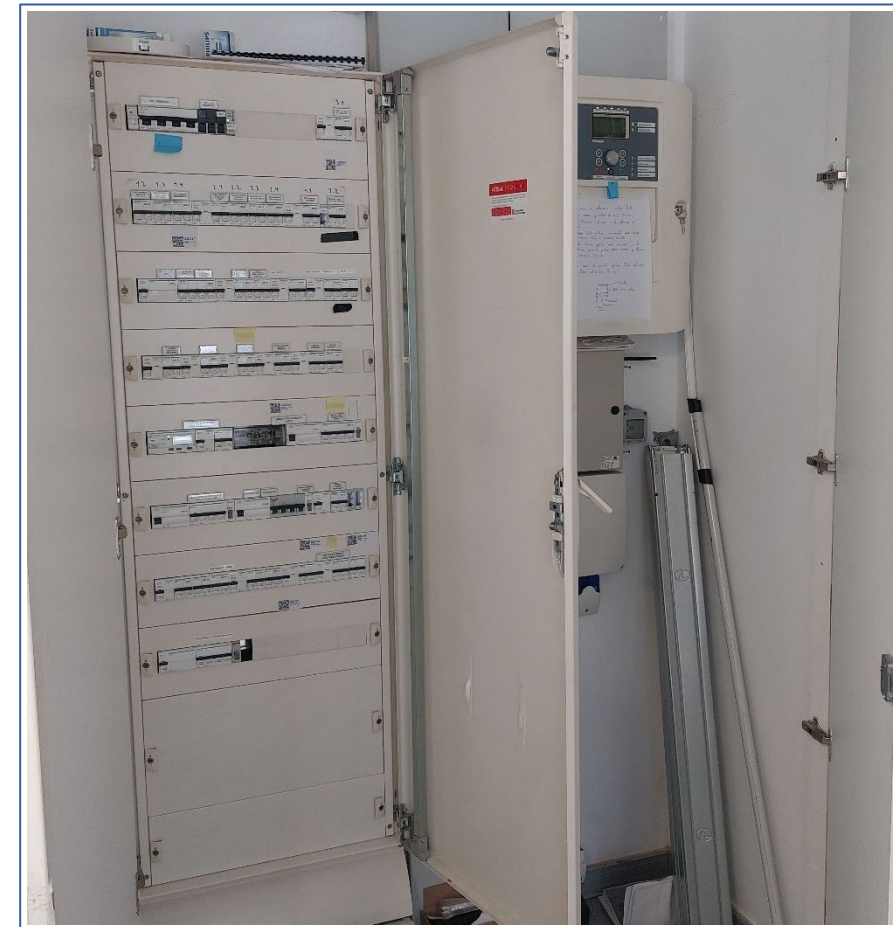
Il·lustració 16: Quadre elèctric de l'Espai Montserrat Roig
