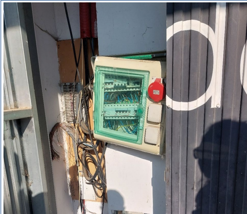
Il·lustració 10: Subquadre existent amb espai pel subquadre nou
