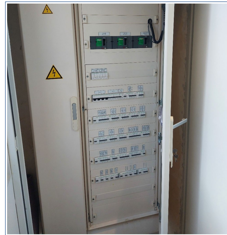
Il·lustració 18: Quadre elèctric de l'Edifici República
