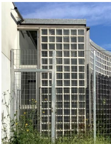
Tancament de vidre emmotllat i fusteria actual que cal enderrocar.
