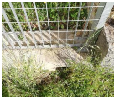
Detall de l'estat dels drenatges del pati exterior
