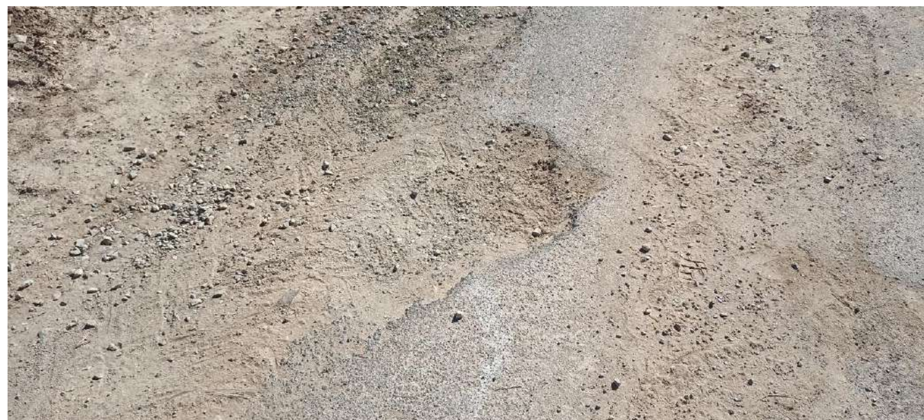
Figura 2. Detall dels sots provocats pel deteriorament del ferm
