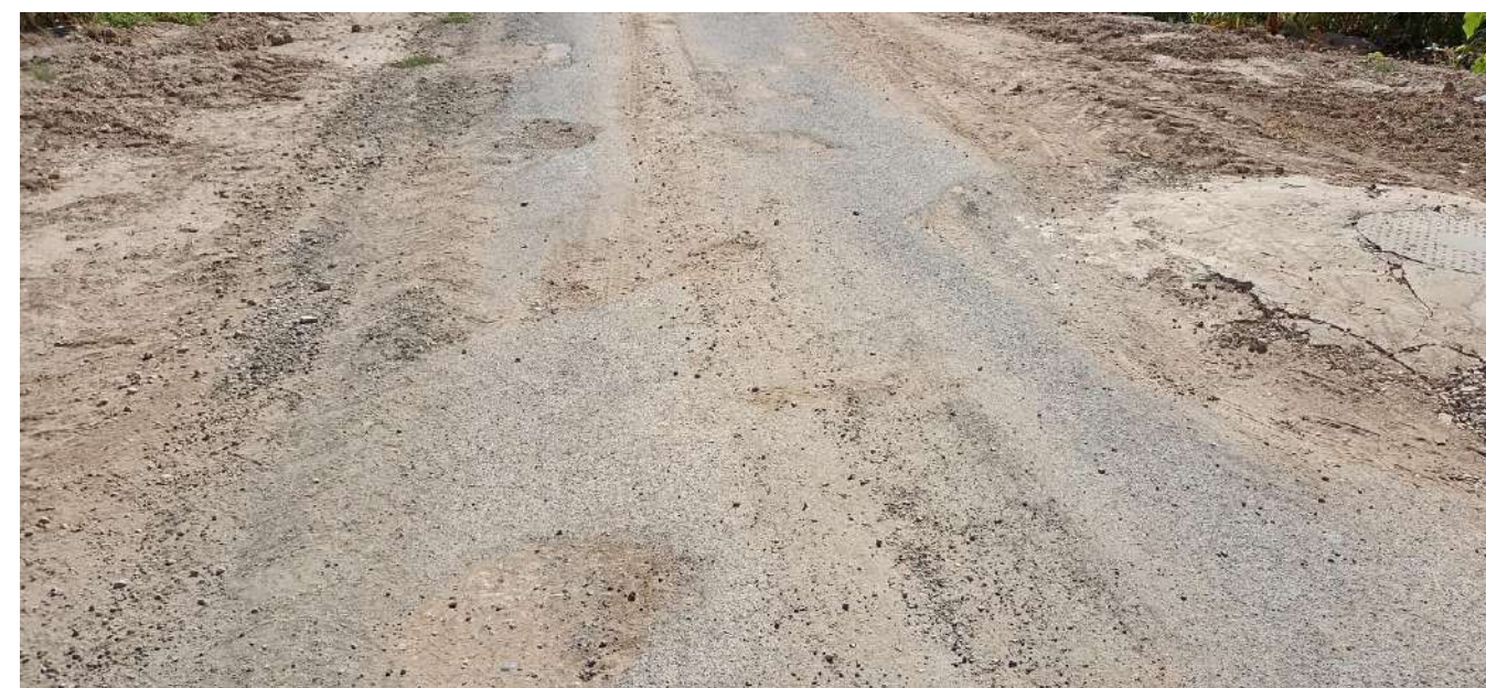
Figura 7. Detall del tram on més afectacions hi ha a raó de la data del projecte
