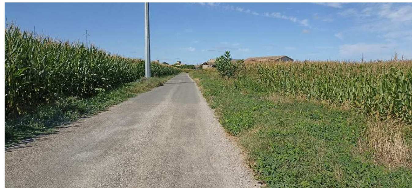
Figura 5. Tram de contacte amb la línia d'alta tensió, on l'estat del ferm és més deficient
