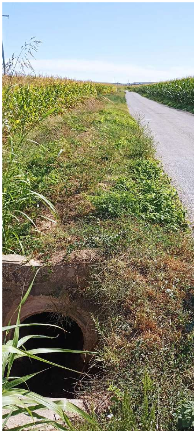
Figura 6. Tram visible del col·lector subterrani de reg al lateral de la via
