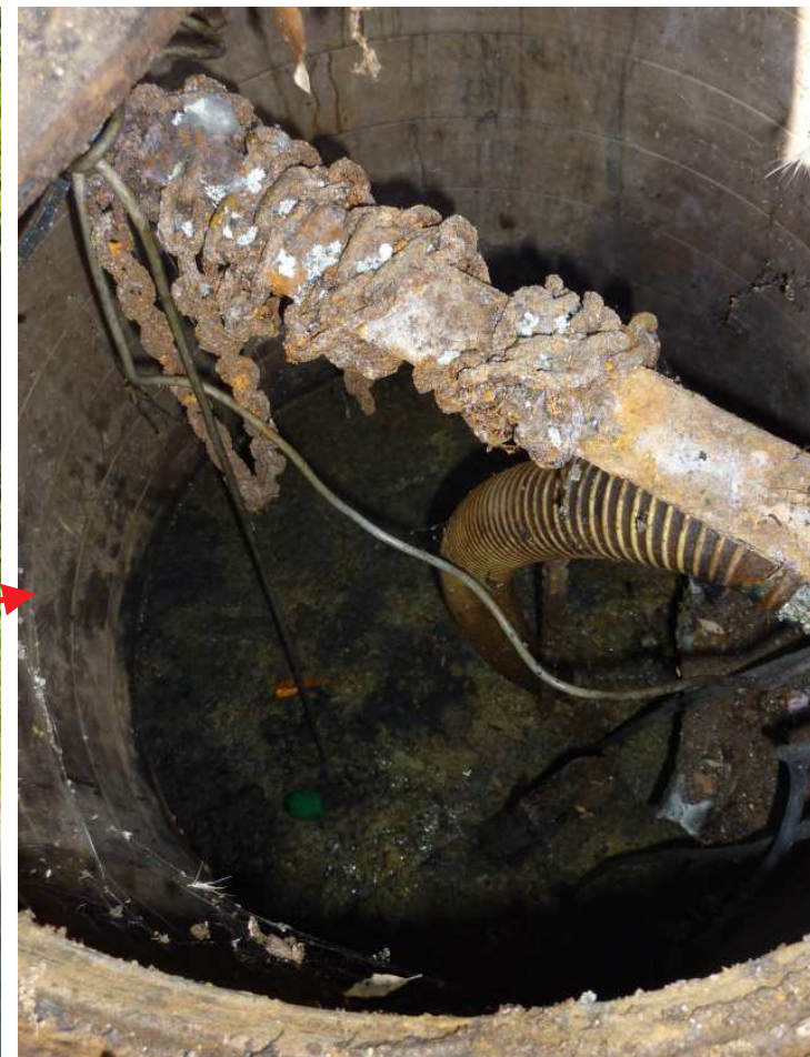
Estació N°2: acumulació aigua residual i bombament cap a l'estació N°1
