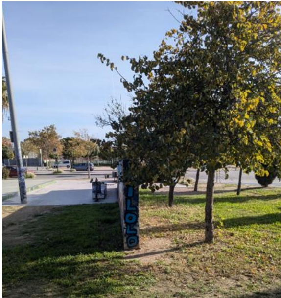
Tram punt connexió enllumenat públic(llumenera esquerre) a Armari nou
