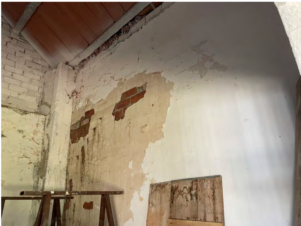
Imatge 15: Paraments interiors amb despreniment de revestiments a sanejar i restituir en aquesta fase.
