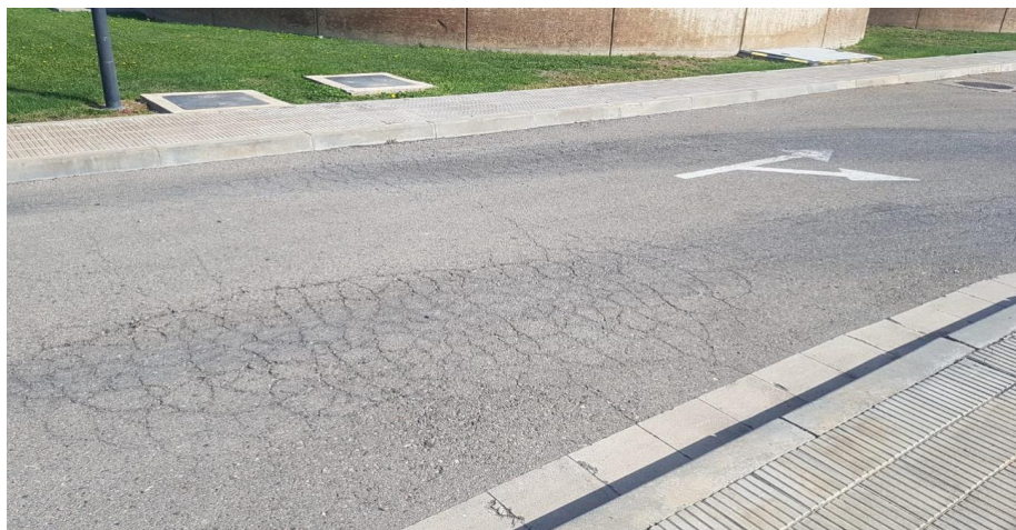
Fig.3. Zona afectada pel gir pronunciat dels camions de fangs
