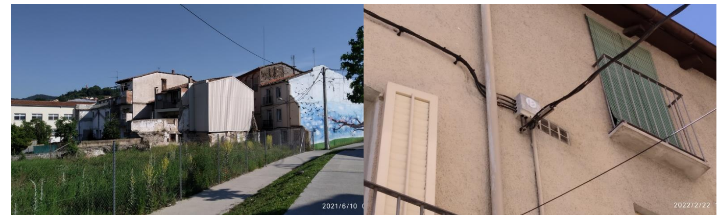
Línia aèria al camí de la Creu, procedent de l'ET
