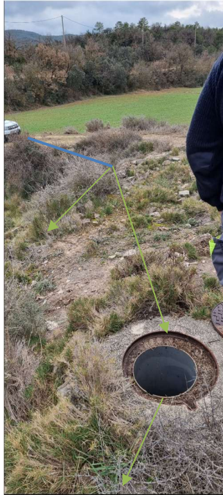
Imatges de les canonada existents a mantenir posteriors a la connexió
