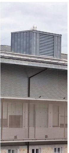
Caseta d'atenuador acústic
