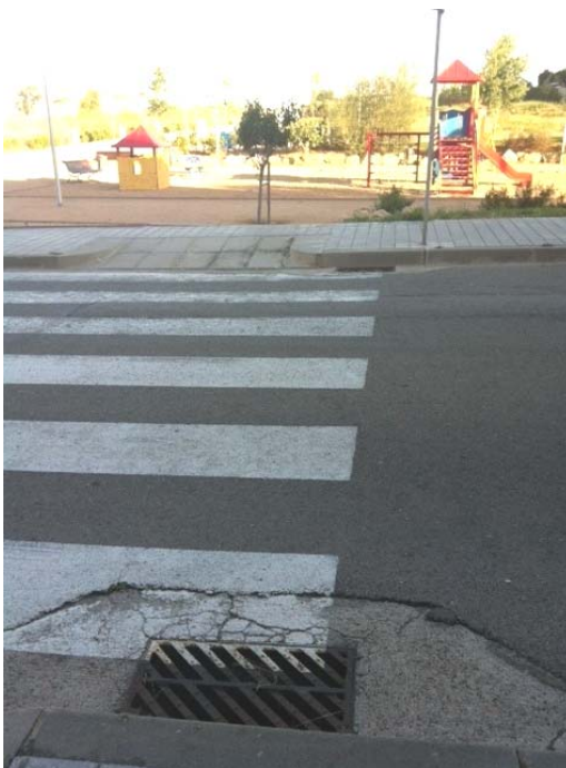
Fotografia F: Embornal afectat a prop d'un parc infantil. C/ del Portal
