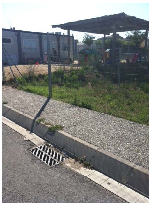
Fotografia G: Embornal afectat a prop d'un centre educatiu. C/ de Susvalls
