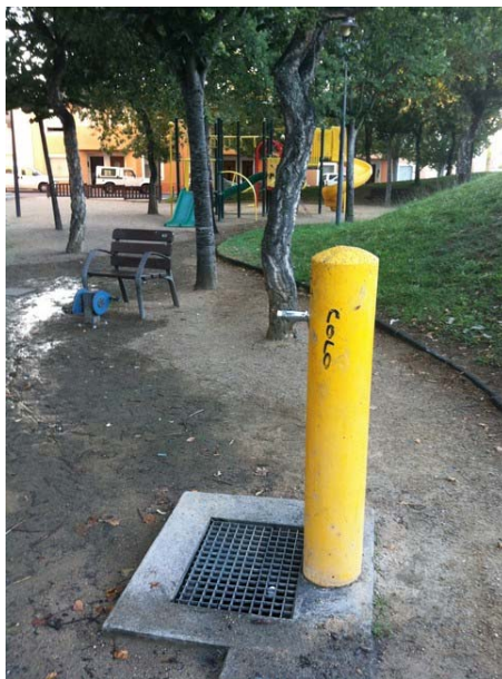
Fotografia D: Font afectada d'un parc infantil. Parc del Carrilet
