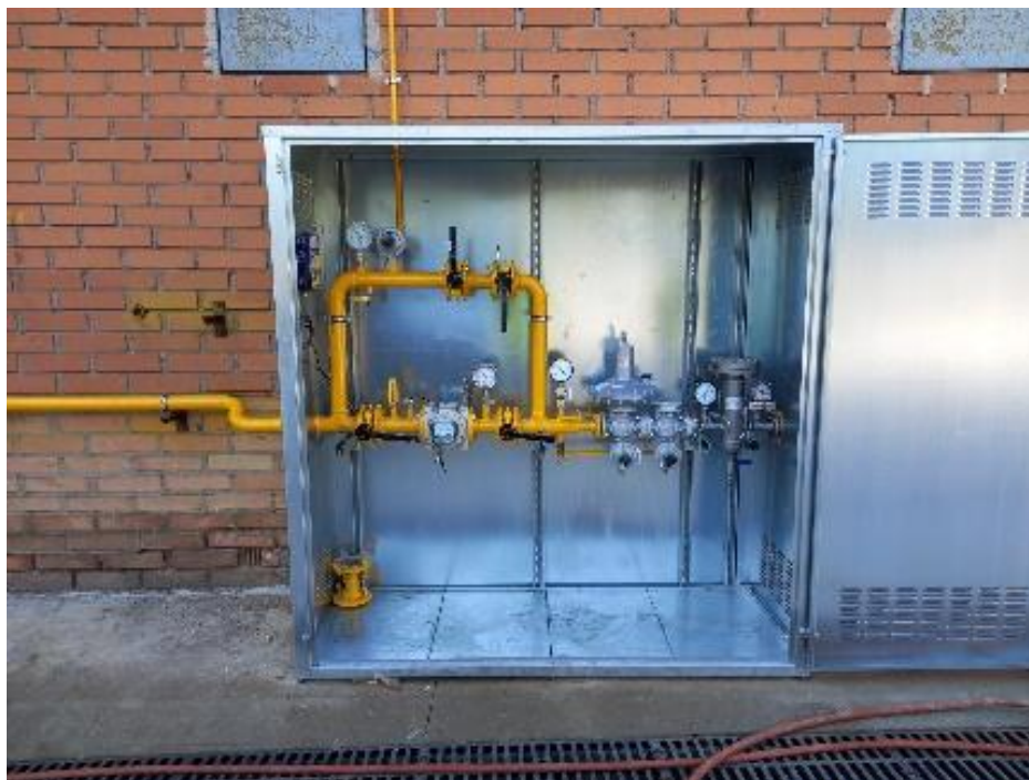
Foto 2: Interior de l'armari de comptatge de Martorell taller mòbil.
