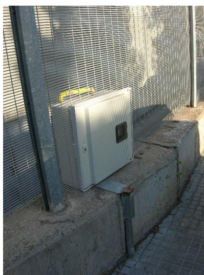
Foto 6: Situació de l'armari de comptatge de Rubí Instal·lacions Fixes
