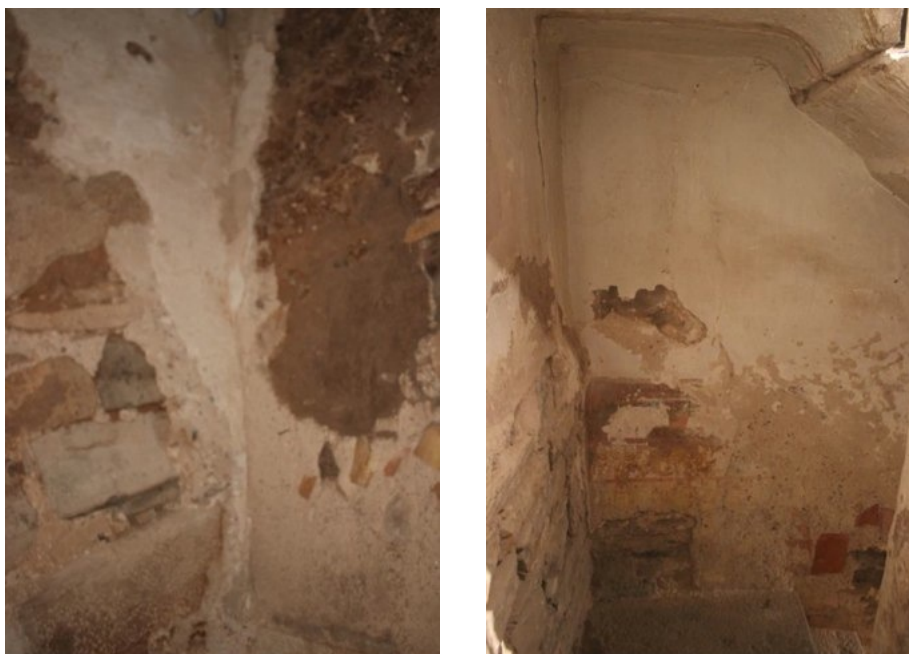
Alguns dels punts on es preveu l'obertura de cales de prospecció per entendre part del sistema constructiu de l'edifici i de la successió d'estrats de calç i pintura als paraments.
