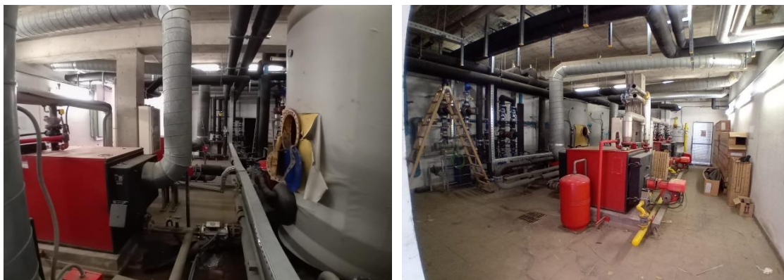
II-lustració 6: Situació actual de les calderes i els acumuladors, ambles canonades de biomassa pel mig.
