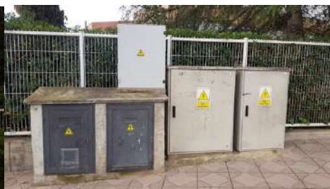
Localització quadre elèctric
