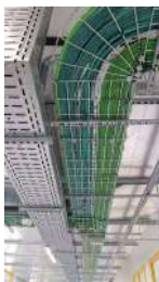
Safata cablejat Rack Gimnàs
