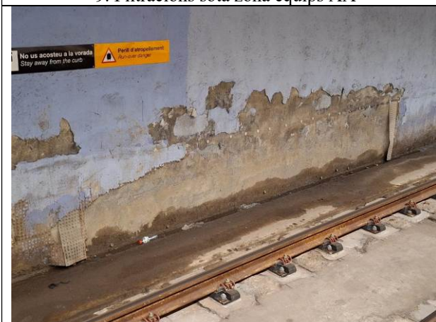
11.Revestiment làmina deteriorat
