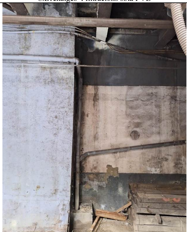
10. Arqueta recollida cua de via 1
