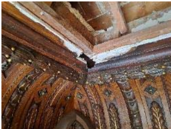
Figura 26. Afectacions en enteixinat per humitats i filtracions de la coberta
