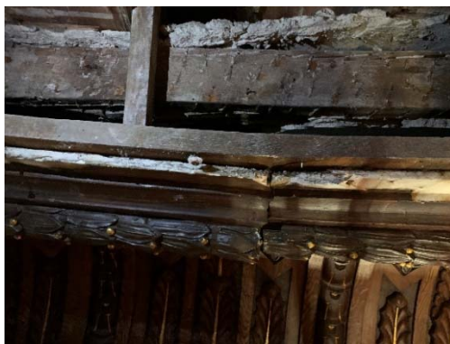
Figura 27. Fissures en motllura.
