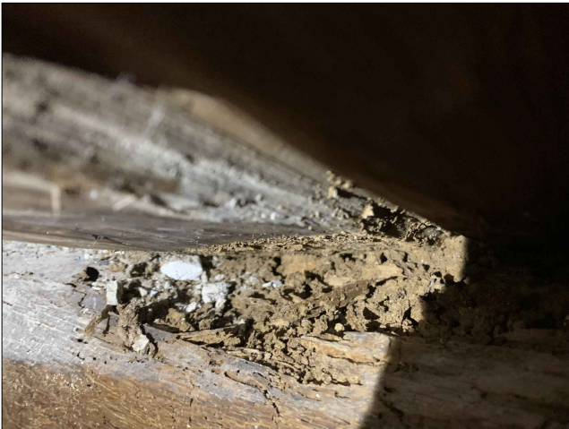
F.10_Patologies en la estructura de fusta_Enteixinat Sala de Plens
