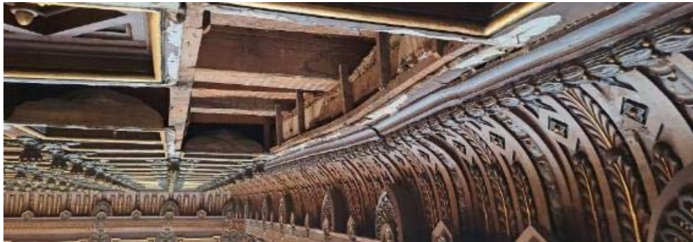
Figura 29. Manca de planaïtat en fals sostre.
