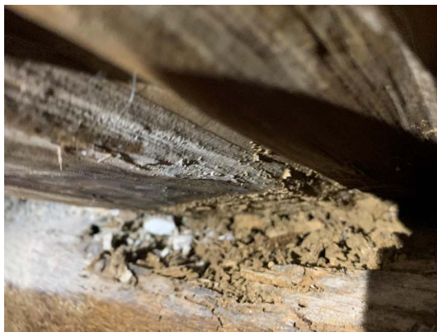
Figura 30. Afectacions en secció de fusta de dorment.
