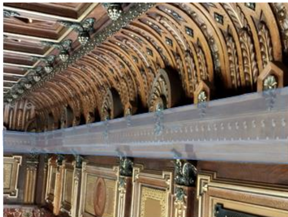
Part inferior de la cornisa amb possible afectació durant l'actuació de retirada de la part superior
