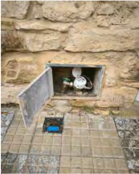
Comptador en pericó al terra a Arnau de Ponç nº 16
