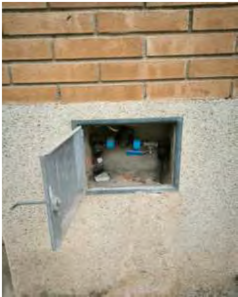
Caixa amb comptador a l'interior, Arnau de Ponç nº 15-B
