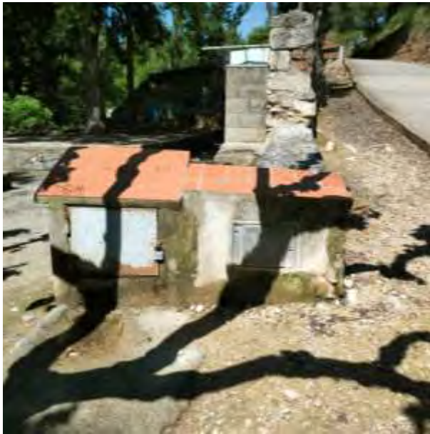
Caixa amb comptador a l'interior, Berenador municipal al Carrer Jaume I
