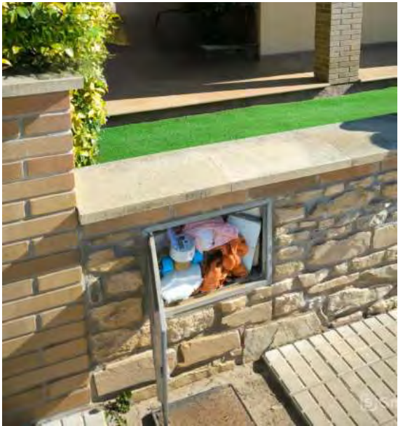
Caixa amb comptador a l'interior, Carrer Sant Salvador nº 5
