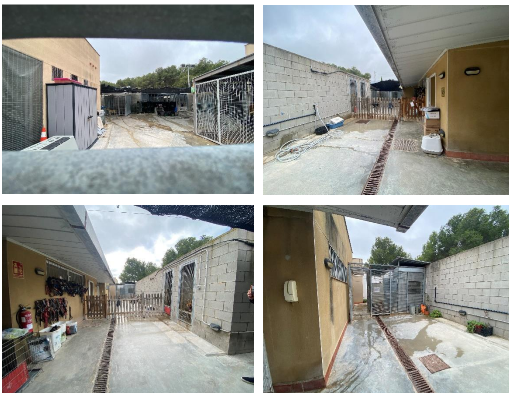
Vistes de l'espai de circulacions on s'evidencia la falta d'espai d'emmagatzematge i l'estat dels paviments i desaignes.
