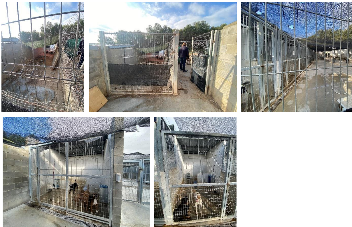
Vistes de l'estat precari dels paviments, desaigües i les tanques
