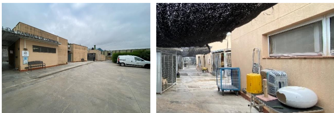
Vistes de l'exterior dels volums i interior des de l'espai de circulacions on s'aprecia desperfectes en el tancament de la mosquitera i la pèrdua de material a l'ampit de la finestra.
