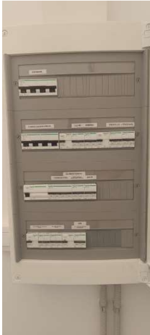
Quadre elèctric existent
