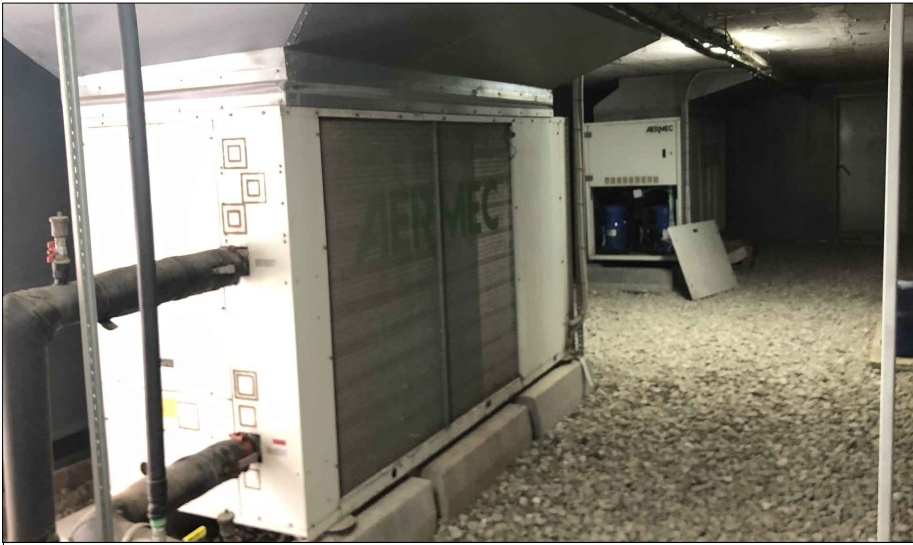
Bomba de calor actual
