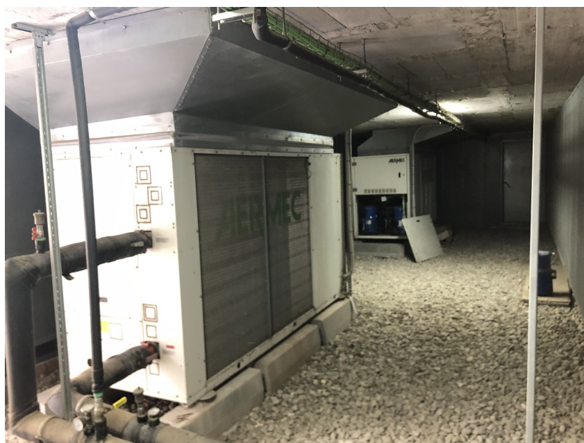
Figura 2: Bombes de calor actuals
