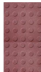
PAVIMENTÀCTIL proximitat a punts de perill ABANS GUÀLS DE PEATONS
