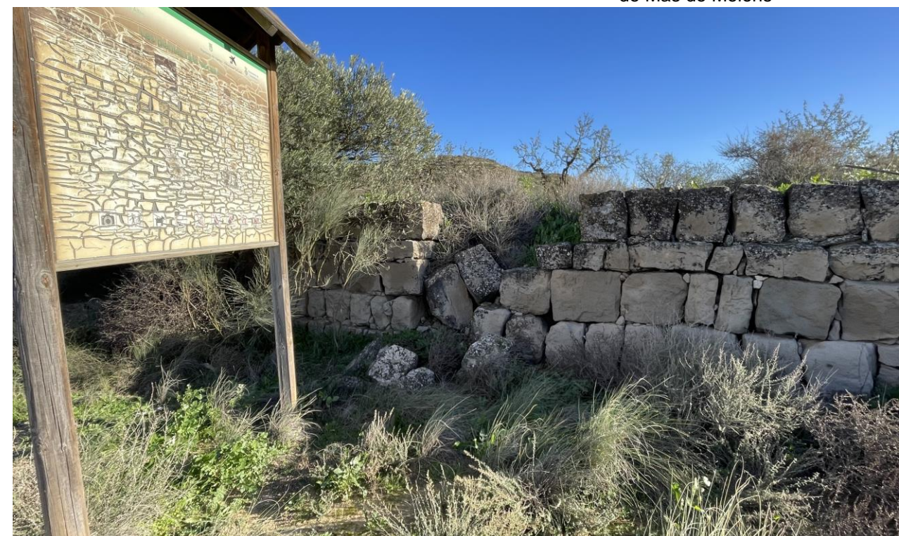
Murs de pedra seca en mal estat a la Vall de Matxerri.
