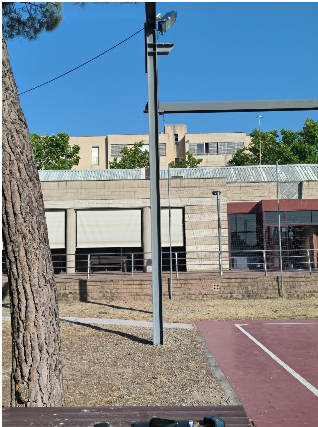
Fotografia 1 Visita pilar pista poliesportiva aparentment desplomat.
