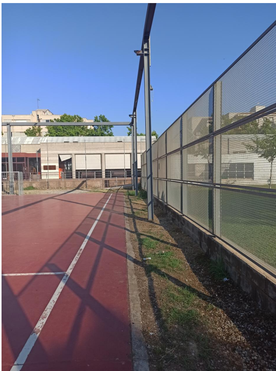
Fotografia 2 Visita pilars pista poliesportiva aparentment desplomats.
