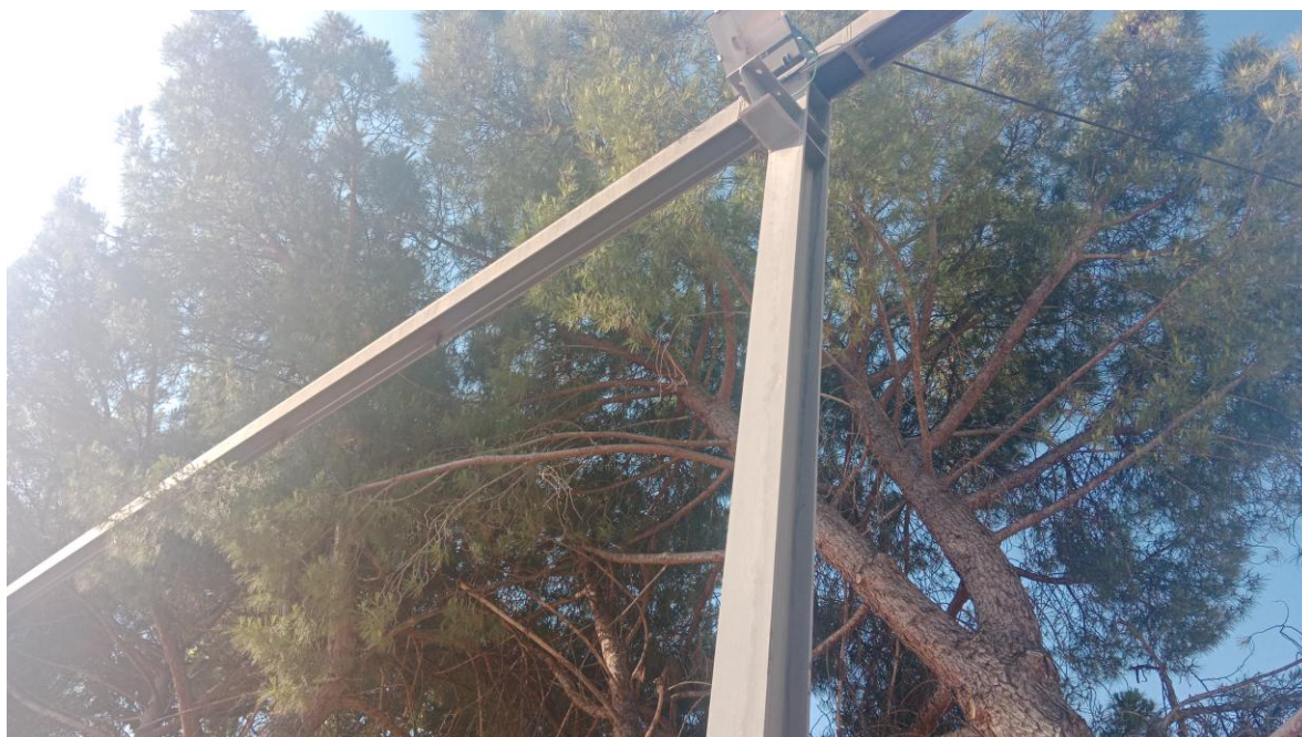
Fotografia 3 Visita pilars pista poliesportiva aparentment deformats.
