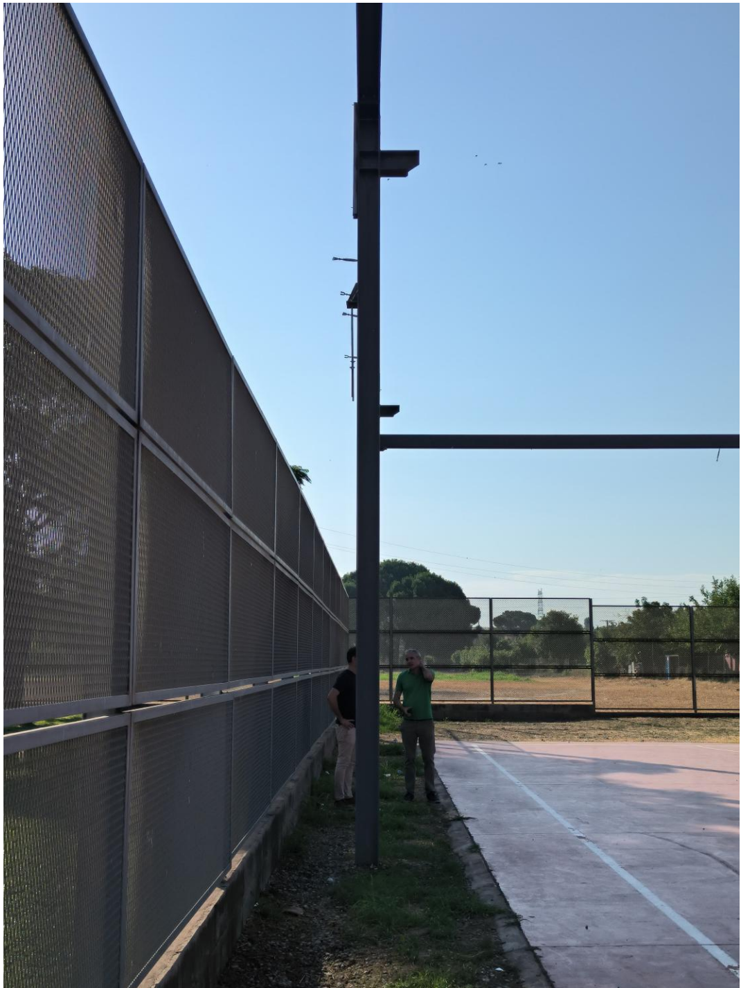
Fotografia 4 Visita pilars pista poliesportiva aparentment desplomats.
