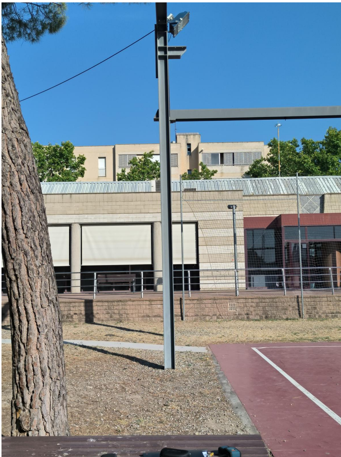
Fotografia 1 Visita pilars pista poliesportiva aparentment desplomats.
