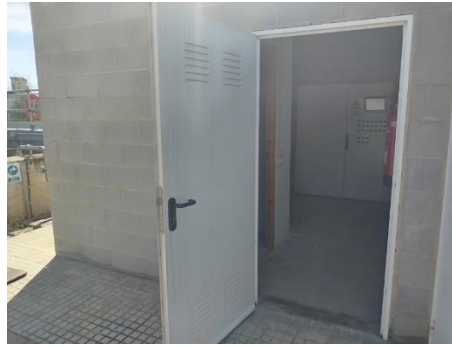
Figura 7. Entrada a l'interior de la caseta, on es destinarà la zona tècnica de la instal·lació fotovoltaica.
