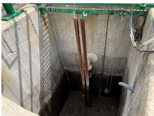
Foto Núm. 7 Detall dels tubs guia a canviar en arqueta de flotants
