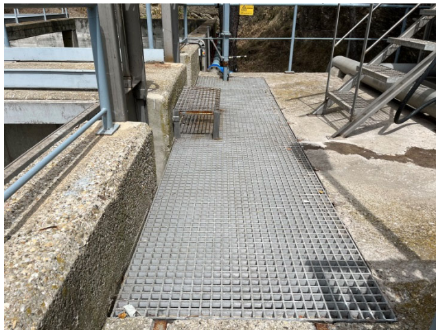
Figura núm.3: Tràmex bancada accés reactors biològics
