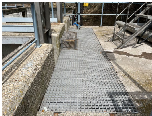
Foto Núm. 4 Detall tramex esglaó accés reactor biològic a canviar
