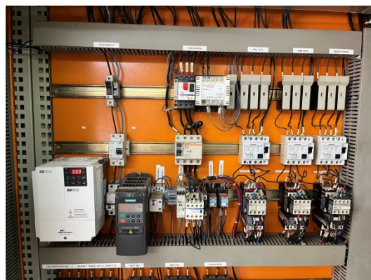
Foto Núm. 12 Detall quadre elèctric a ampliar
