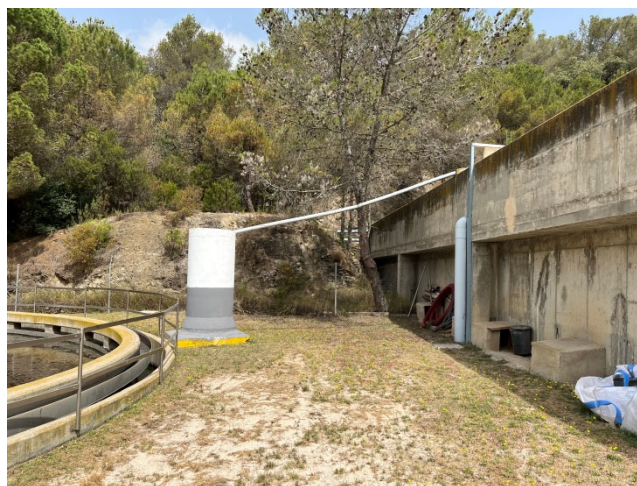
Figura núm.5: Tub aeri entre els reactors biològics i el decantador secundari
