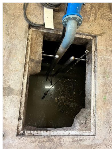
Foto Núm. 14 Detall de l'interior de l'arqueta de la bomba a substituir
