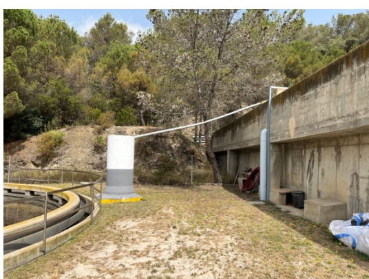
Foto Núm. 9 Detall tub aeri escumes reactor biològic – decantador secundari a canviar
