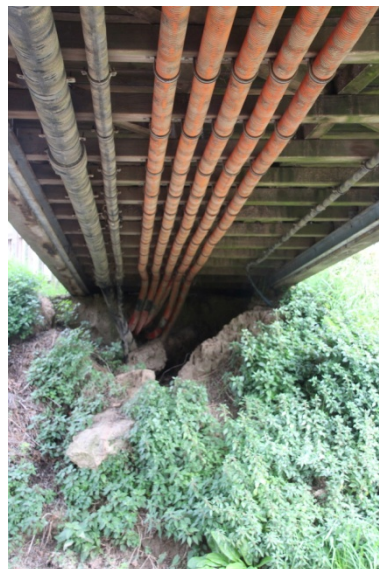
Imatge 7: Patologies observades
