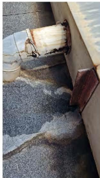
Figura 23. Corrosió dels elements de suport de les canals
