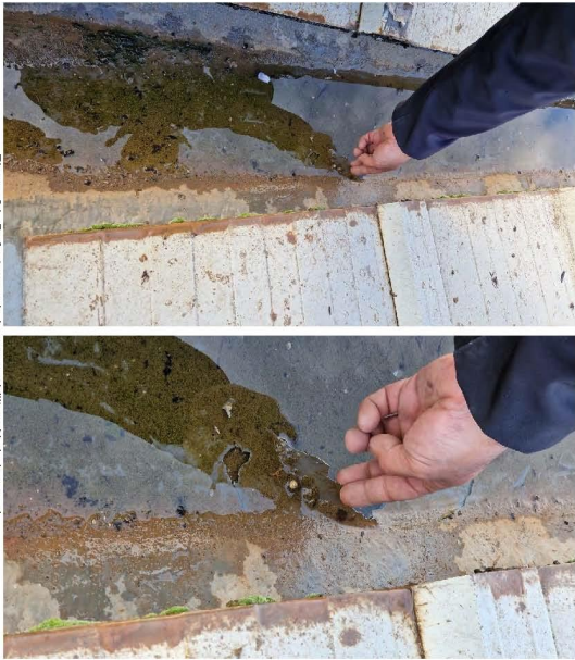
Figura 21. Defectes en la impermeabilització de la canal
