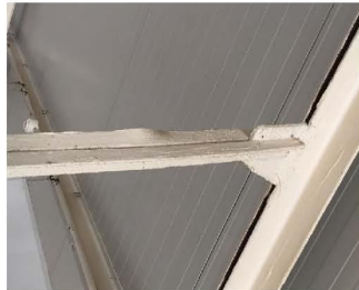
Figura 26. Perfil localment deformat
