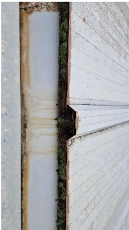
Figura 16. Deteriorament dels poliuretàs de les plaques
