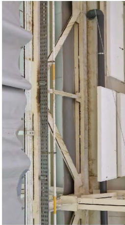
Figura 13. Efectes de les filtracions sobre l'estructura
