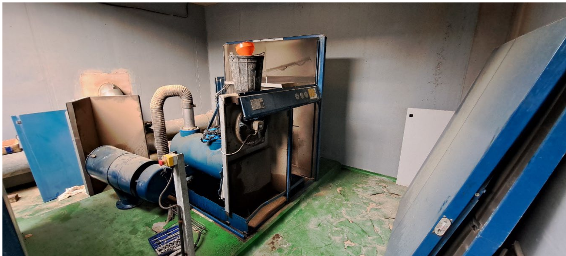
Foto Núm 1: Vista de la bufant a substituir
