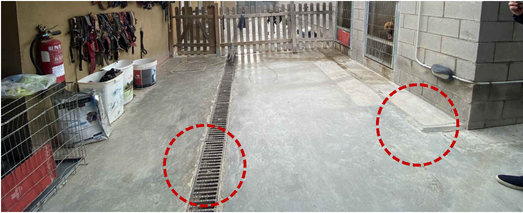
V4. Degradacions i irregularitats en paviment. Font: GAA 17/06/24
