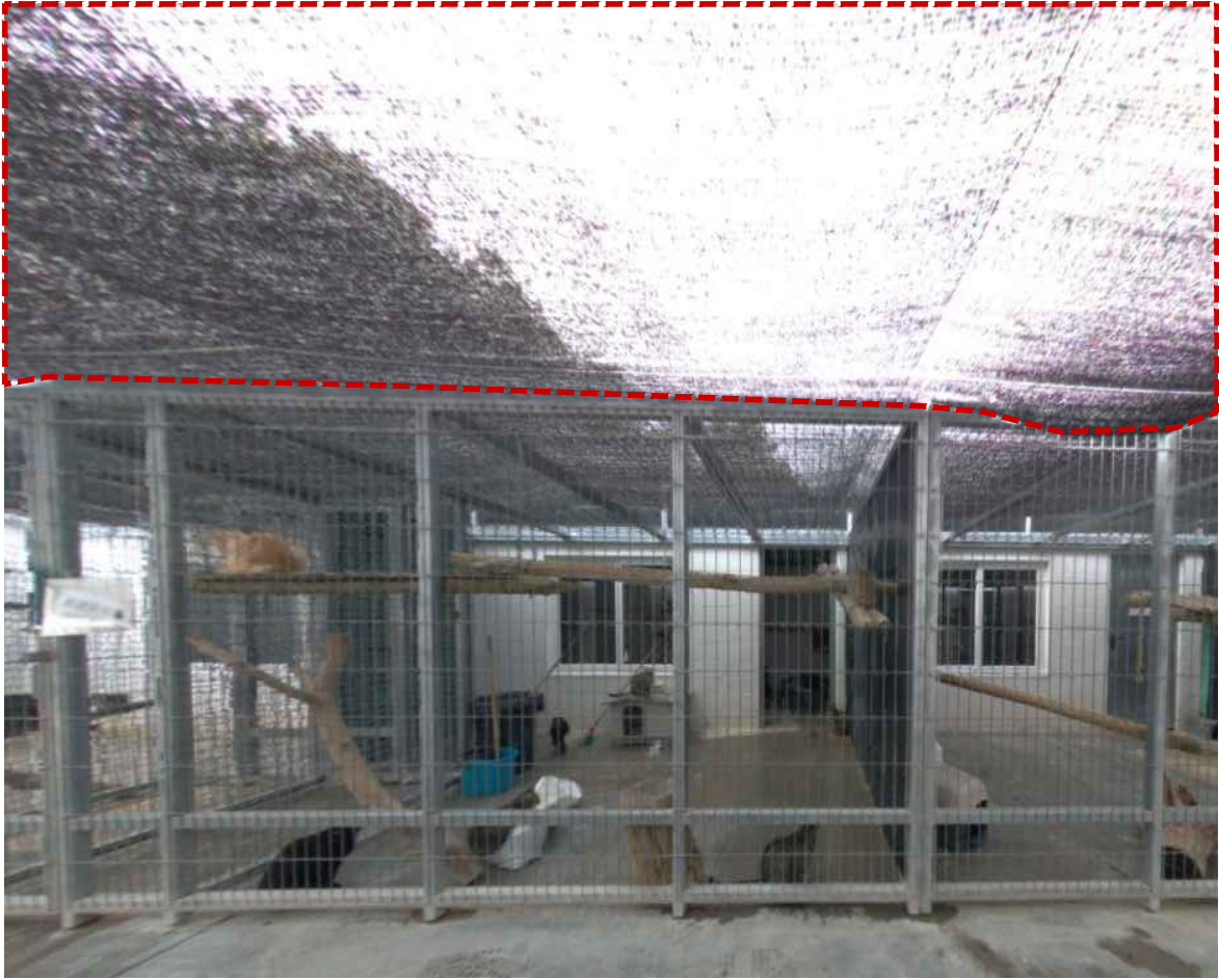
V3. Tendalls d'ombra provisionals en mal estat Font: GAA 17/06/24
