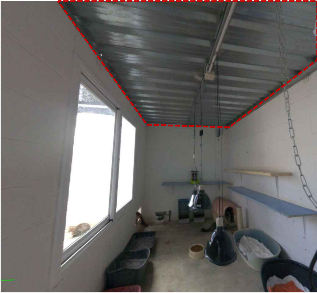
V3. Manca d'aïllament tèrmic a la coberta Font: GAA 17/06/24
