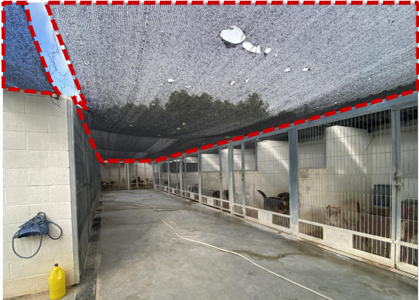
V3. Tendalls d'ombreig deficients i en mal estat Font: GAA 17/06/24
