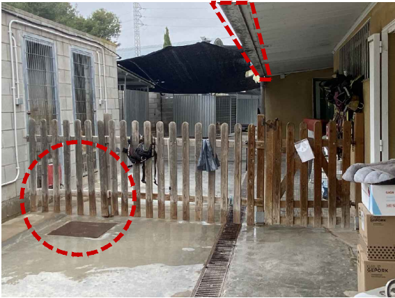
V2. Tanca de fusta degradada per contacte aigua. Font: GAA 17/06/24
