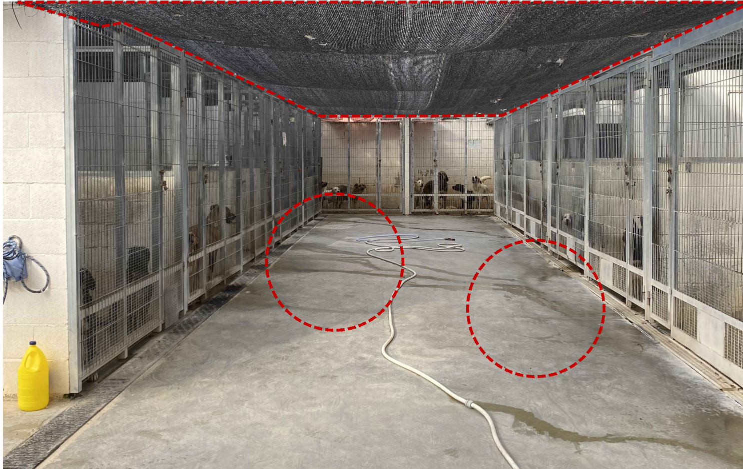
V7. Pendents i drenatge superficial insuficient. Gosses enfrontades amb problemàtiques de visuals directes. Font: GAA 17/06/24
