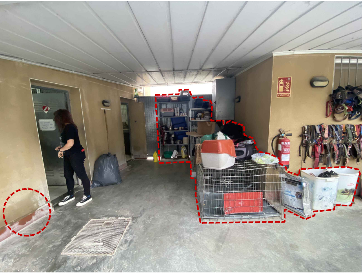
V5. Manca d'emmagatzematge. Degradació de paraments verticals per orins de gos. Mal accés a extintors. Font: GAA 17/06/24
