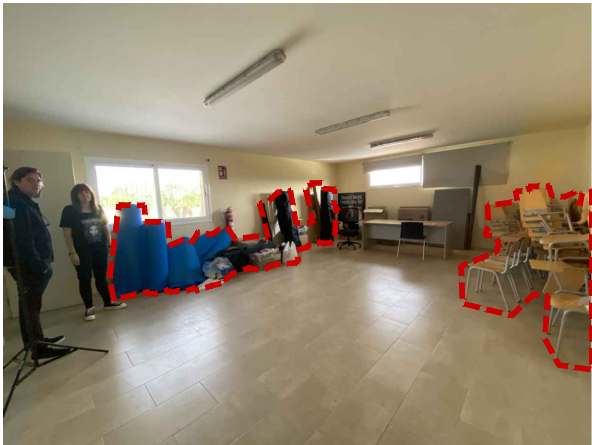
V4. SALA MULTIUSOS. Manca d'emmagatzematge. Bloqueig accés extintor. Font: GAA 17/06/24
