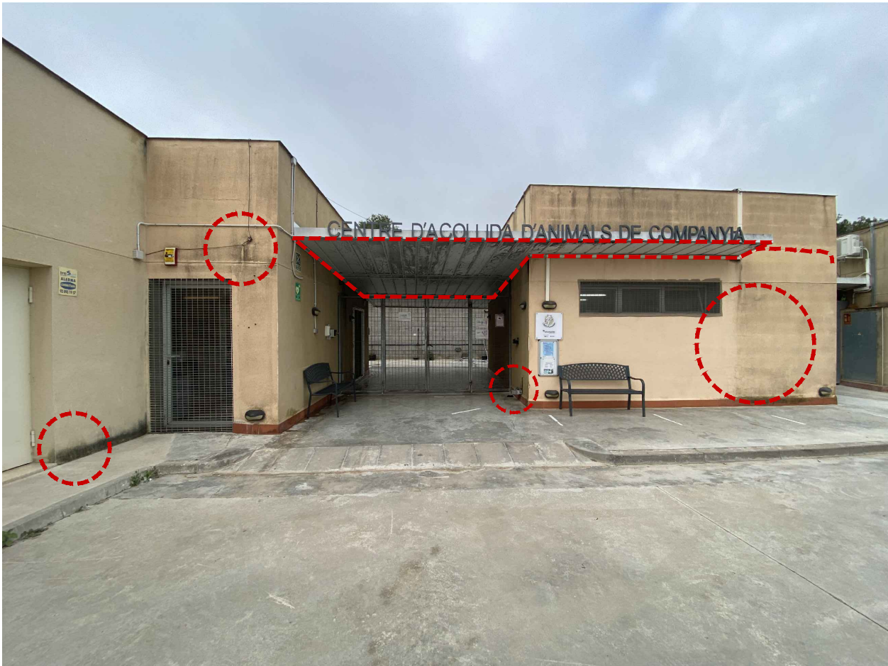
V7. Revestiments exteriors i instal·lacions en mal estat. Humitats per capilaritat i taques d'aigua de pluja, amb eflorescències i taques biogèniques. Fissures en revestiments. Font: GAA 17/06/24
