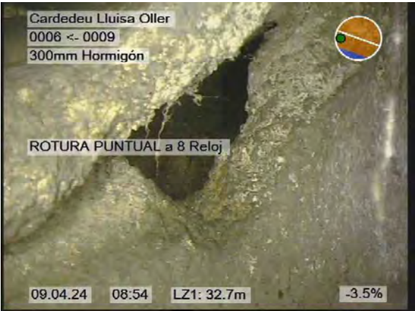
13.jpg, 00:05:16, 32.70m ROTURA PUNTUAL a 8 Reloj
