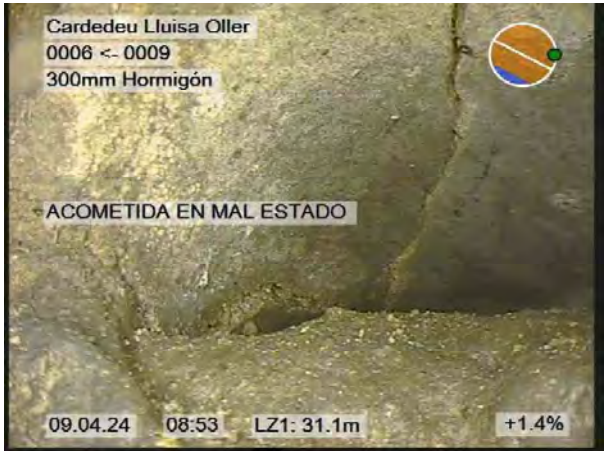
10.jpg, 00:04:35, 31.10m ACOMETIDA EN MAL ESTADO
