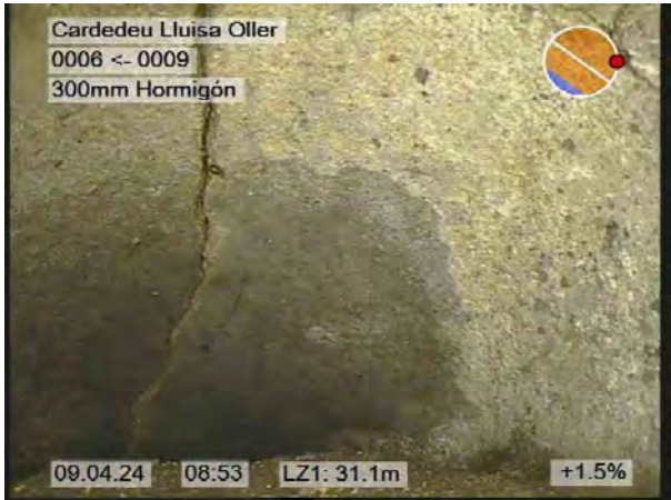
11.jpg, 00:04:35, 31.10m ACOMETIDA EN MAL ESTADO
