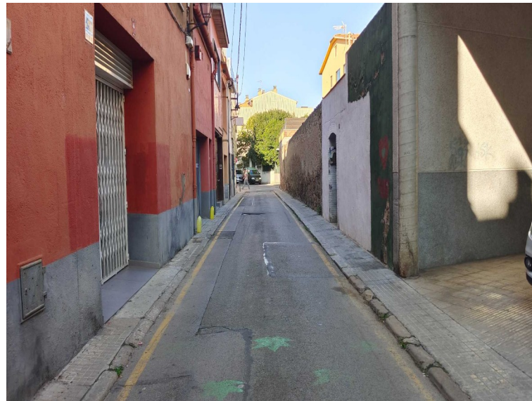
Figura 5. Vista de l'estat dels paviments al carrer Lluïsa Oller
