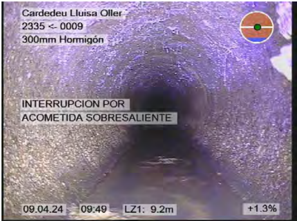
21.jpg, 00:01:10, 9.20m INTERRUPCION POR ACOMETIDA SOBRESALIENTE
